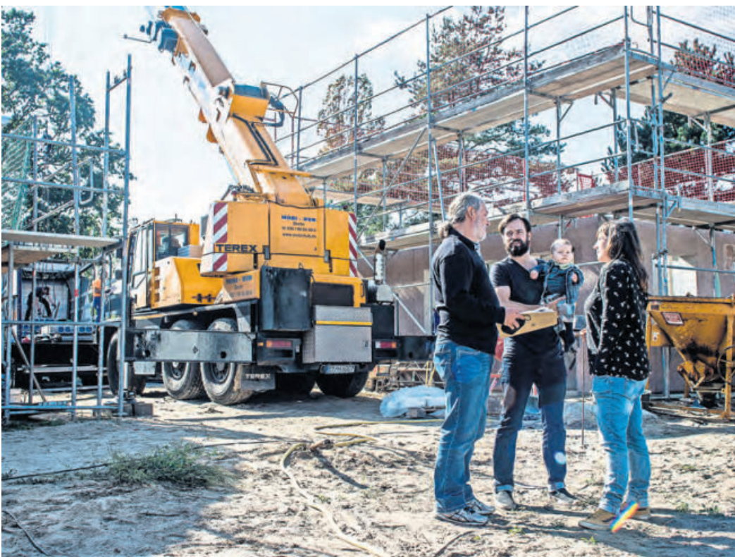
Alles im Plan? Zahlungspläne dürfen Abschlagszahlungen nur nach tatsächlichem Baufortschritt auf der Baustelle einfordern. Foto: djd/Bauherren-Schutzbund
