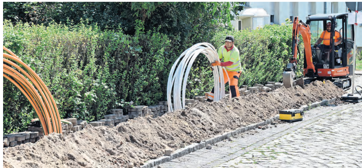
Aktuell wird Glasfaserkabel in Torgau in der Domnitzscher Straße/Ecke Bärwinkelstraße verlegt. 8500 Haushalte und Unternehmen sollen bald vom schnellen Internet profitieren. Foto: SWB/HL
