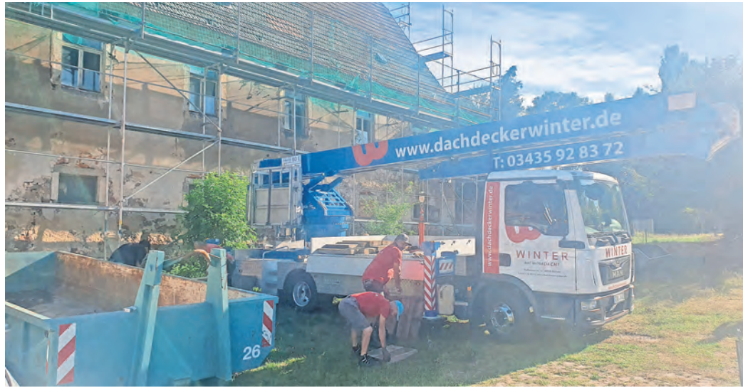
Baufortschritt zum Anfassen: Im Berggut kommt das alte Dach runter, um es vor dem neuen Eindecken baulich bewerten zu können. Fotos: Jochen Reitstätter
