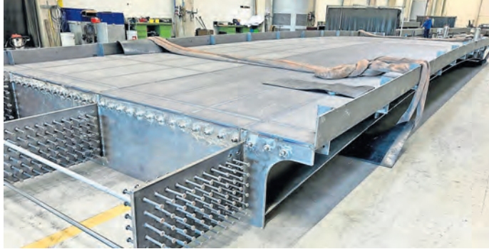
So sieht das Innenleben aus – die neue Fußgängerbrücke zum Torgauer Bahnhof soll noch in diesem Jahr fertig werden.
