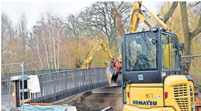
Restarbeiten laufen aktuell an der Fußgängerbrücke über den Schwarzen Graben zum Torgauer Bahnhof - lassen es die Witterungsbedingungen zu, soll sie am 20. Dezember freigegeben werden. Foto: SWB/HL
