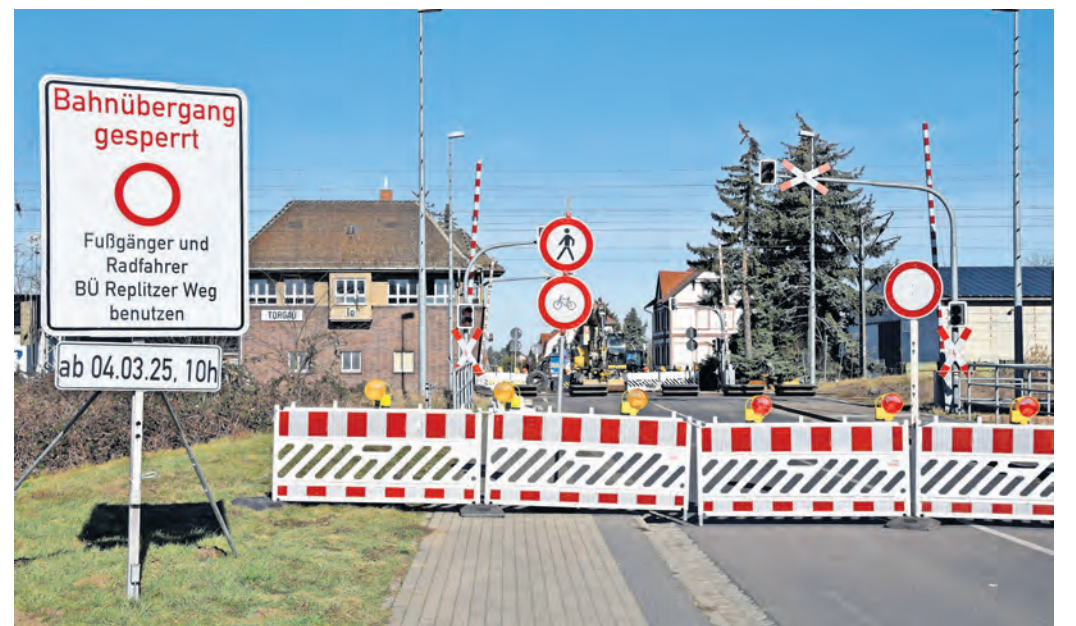
Der „Schilderwald“ verheißt nichts Gutes: Der Bahnübergang Döbernsche Straße ist gesperrt. Nach dem Dafürhalten vieler Anwohner und Kraftfahrer, welche die Strecke täglich nutzen, kam die Ankündigung der Deutschen Bahn recht spät. Fotos: SWB/HL
