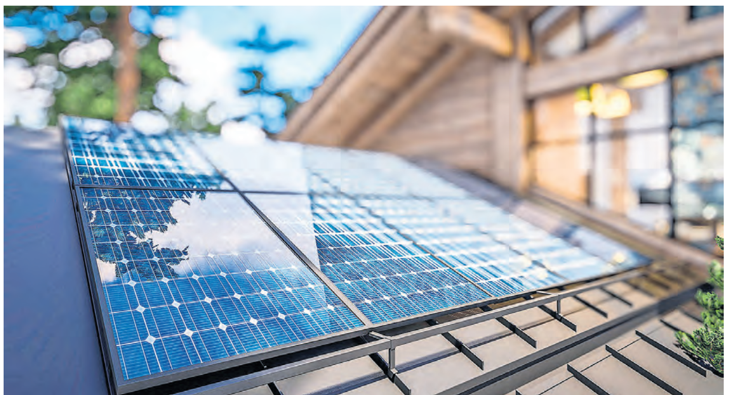
Solarmodule liefern Erneuerbare Energie - auch bei den Stadtwerken Torgau.
