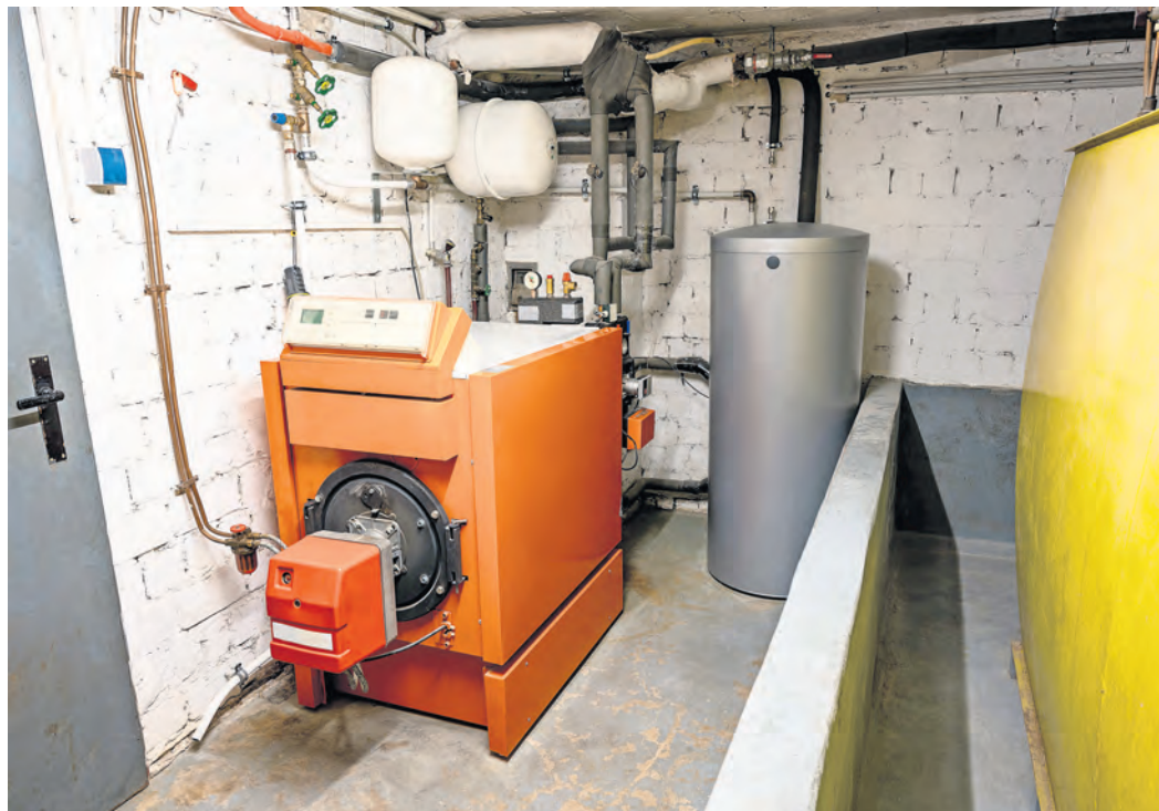
Funktionierende Heizkessel müssen in der Regel nicht ausgetauscht werden. Erneuerbare Energien lassen sich auch anders ins Haus einbinden, etwa über eine Solarthermie- oder PV-Anlage oder Holz-Kaminöfen.
