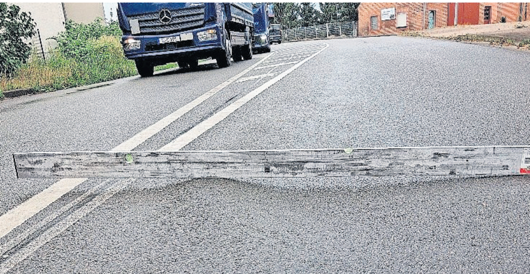
Durch die Hitze hat sich die Asphaltdecke auf der B 2 in Gollmenz verformt.
