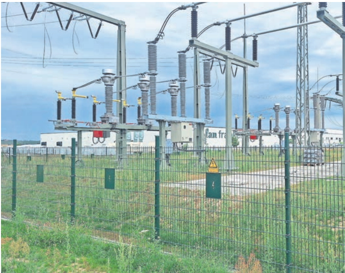
Auf dem Gewerbegebiet am Wellerswalder Weg sind dank des sanierten Umspannwerks geeignete Bedingungen für energieintensive Unternehmen. Foto: Jochen Reitstätter
